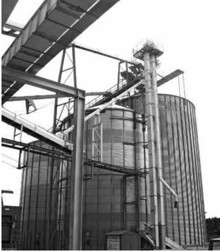
Komplexe Fördertechnik: Über Rohrgurtförderer und Becherwerk gelangen die Pellets zu den Silos
