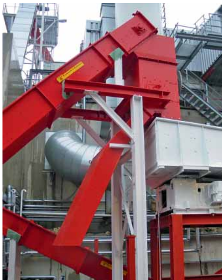
Trogkettenförderer mit FE-Abscheidung wenige Tage vor der Inbetriebnahme
