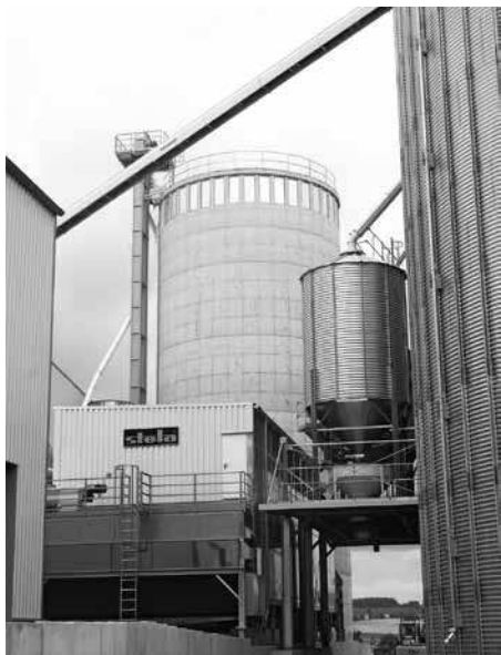
Bandrockner von Stela Laxhuber mit 90 kW-Abluftventilatoren sowie sechs Heizregistern
