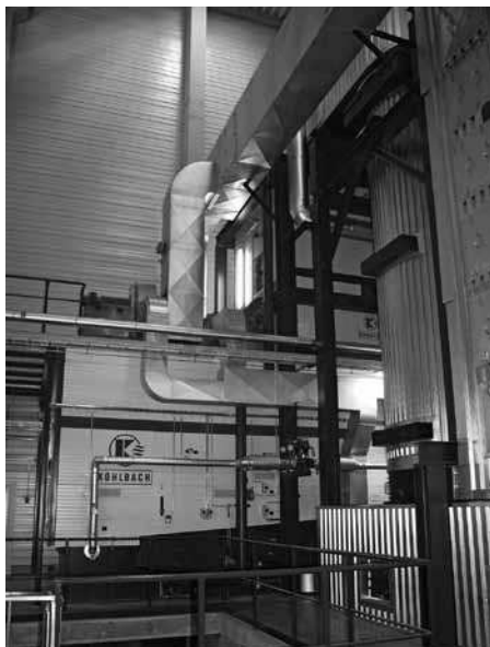
Kohlbach-Thermoölkessel in neuer Bauart (Thermoölkessel seitlich) in Hosenfeld
