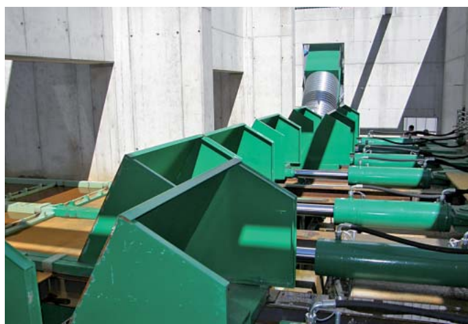
Hydraulisch betätigte Schubböden und Befüllung der KWK über Kratzkettenförderer
